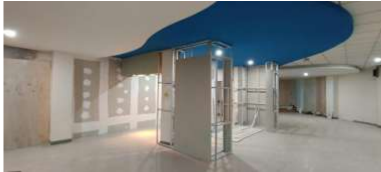
Gambar 9. Proses perapihan dinding, plafon, dan titik lampu pada area Lobby Sekolah Pilar Indonesia
