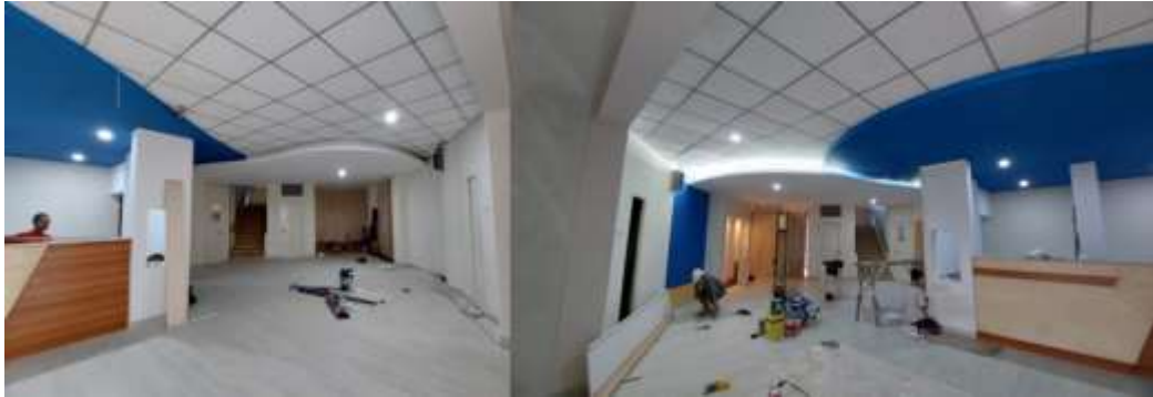
Gambar 10. Proses pemasangan meja lobby dan lantai pada area Lobby Sekolah Pilar Indonesia
